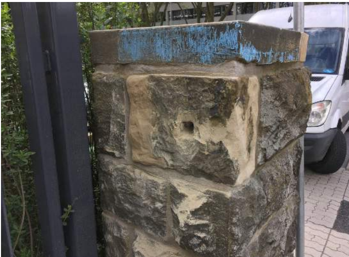
Steinwunde nach Entfernung eines korrodierten Eisenhaken
