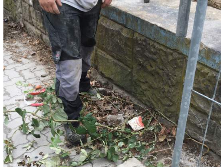
Starker biogenen Befall auf der Sandsteinoberfläche
