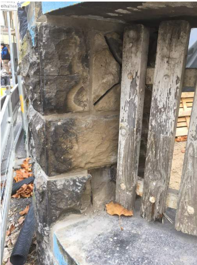
Rissbildungen durch Korrosion
