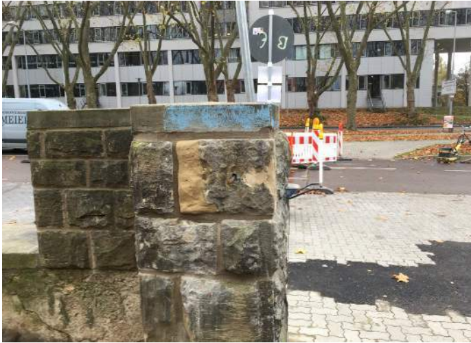
Ergänzte Fehlstelle an Mauerwerksquader des westl Torpfosten
