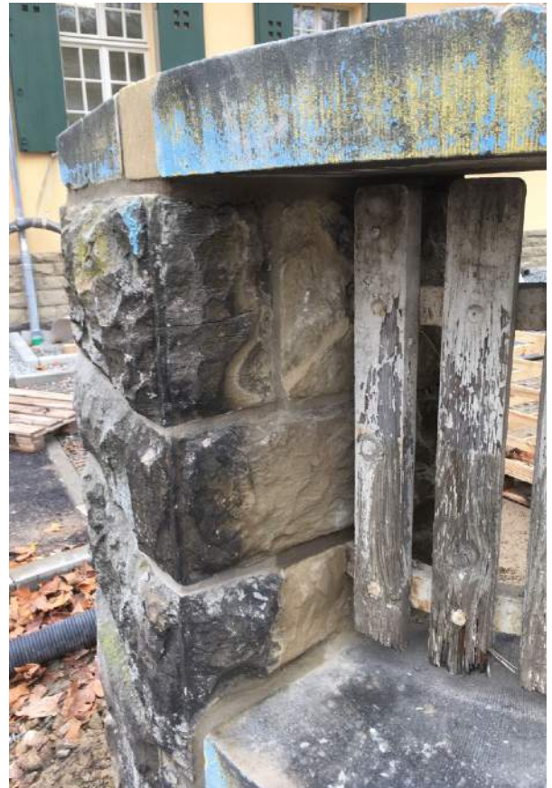
Geschlossene Risse im KSE-Modulsystem
