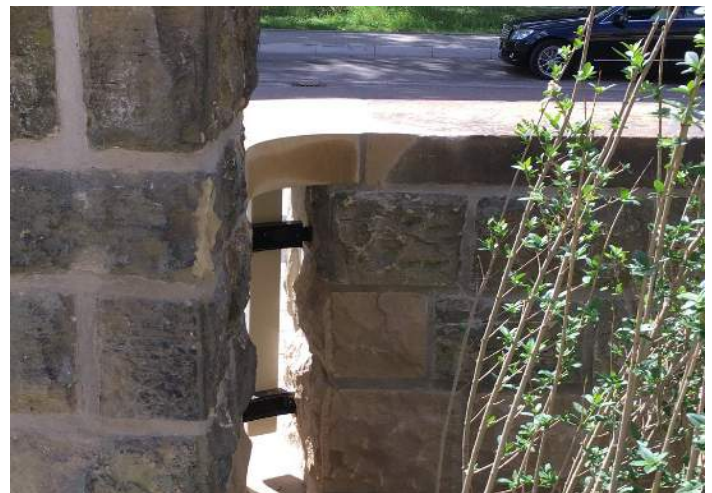
Ergänzte Fehlstelle an geschweiften Sandsteinabdeckung
