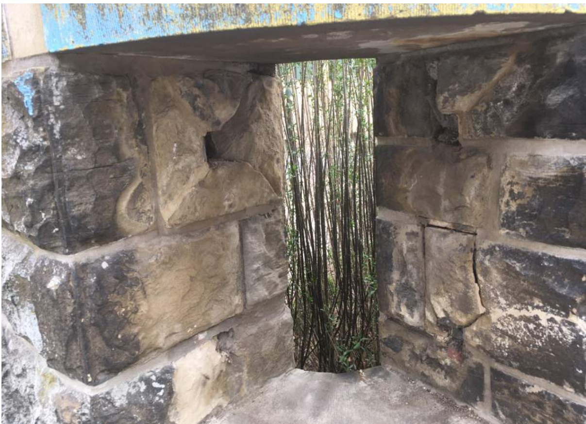
Nach Entfernen der korrodierten Metallhalterungen vor der Rissverpressung (rechts)
