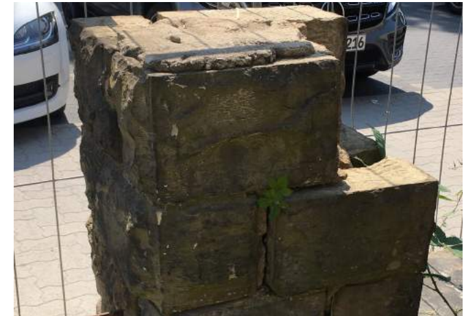
F 8: Fehlender Stein an der hinteren Ecke SP 6
