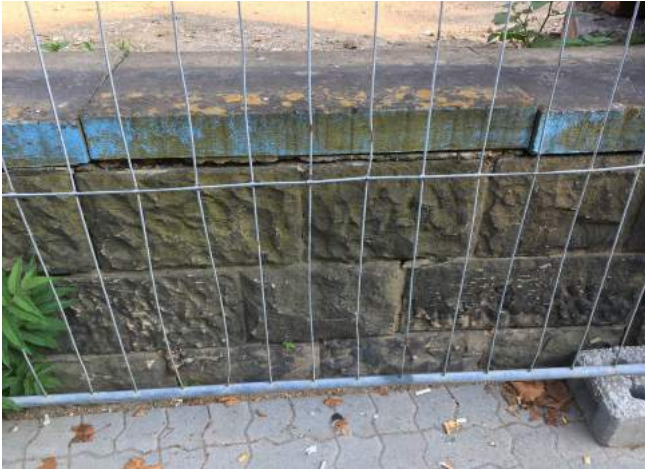
G 5: Stirnseite der Mauerkronen zwischen SP 1 und SP2
