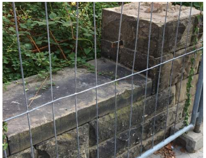
f 2: an der Oberkante Ansichtseite der rechten Abdeckplatte zwischen SP 3 und SP 4.
