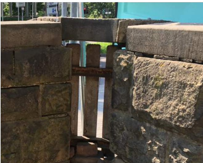
L 1: Geschweifte Abdeckung im Anschluß an den westl. Torpfosten TPWest hat es durch Setzung des Torpfosten aus dem Gefüge gehoben.
