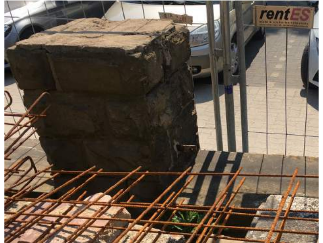
E 2: SP2 fehlende Zaunverankerung oben rechts von Norden aus gesehen.
