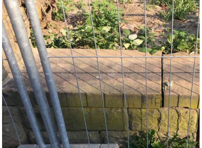
L 5: Linke Mauerkrone zwischen SP 6 und TP Ost ist entlang der Stoßfuge nach aussen verschoben
