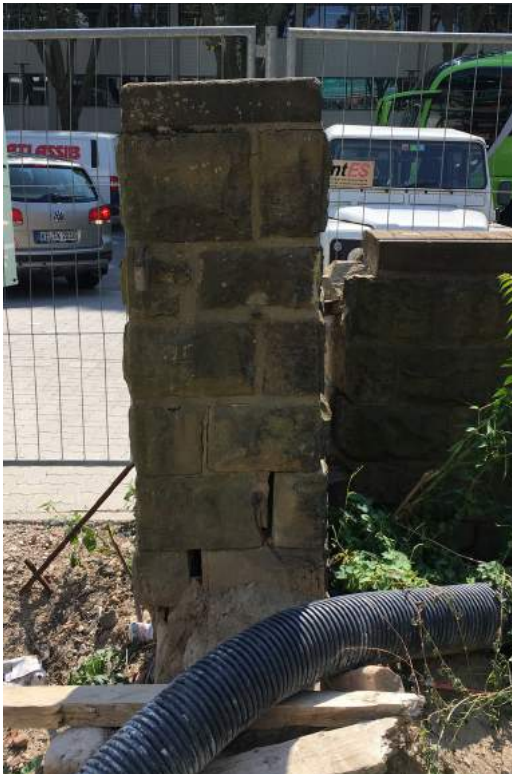
L 7: Torpfosten Ost durch Absenkung des Untergrundes nach aussen geneigt
