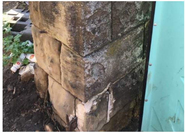
V 8: Die unteren zwei Mauerwerksschichten des westlichen Torpfosten weisen aufgrund Entfestigung einen Verlust der Oberflächenstruktur auf sowie Rissbildung aufgrund des korrodierten Metallkloben
