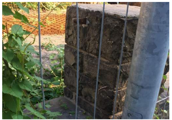
E 4: Fehlende Zaunverankerung unten linksseitig
