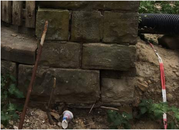
V 7: Der Eckstein der unteren Mauerwerksschicht des östlichen Torpfosten weist eine vollflächige Fehlstelle aufgrund Schalenbildung auf.
