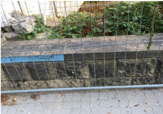
G 7: Die linke Mauerkrone zwischen SP3 und SP4
