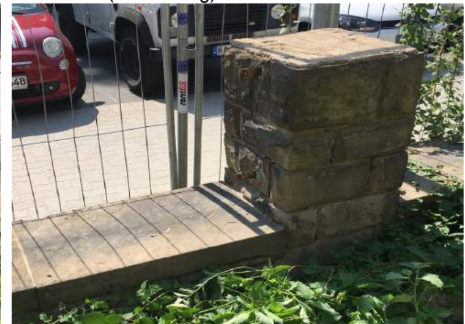
F 4: Fehlende und verlorene Mauerwerkskrone
