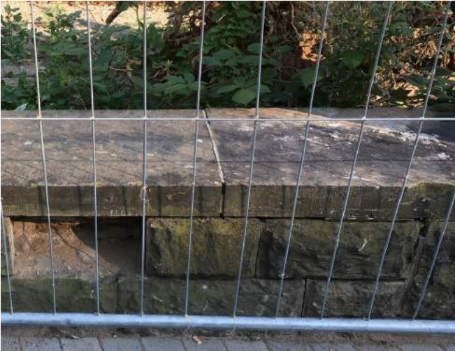
L 3: rechte Mauerkrone zwischen SP 5 und SP 6 nicht mehr fest mit Untergrund verbunden
