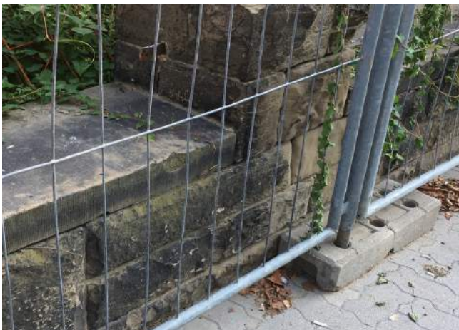
V 5: Schalenbildung am Eckbereich des Pfostenstumpfes SP4 sowie entfestigte Oberfläche am Mauerstein unterhalb des Pfostenansatzes unter Verlust der Oberflächenstruktur
