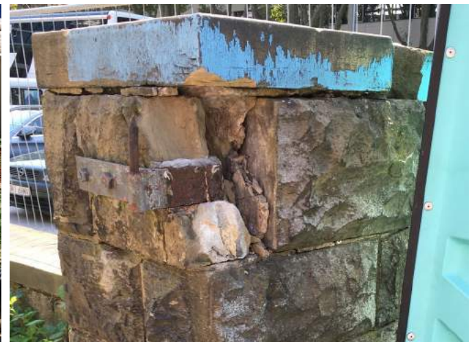
F 8: Durch Korrosion abgesprengter Eckstein des Torpfostenam westlichen Ende der Sandsteinmauer
