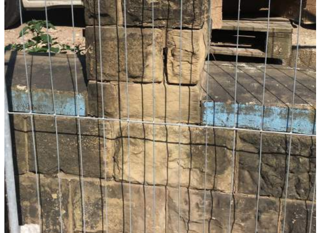
V 2: Schalenbildung am Mauerstein unterhalb des Pfosten (SP1) und entfestigte Oberfläche am Sandstein der unteren zwei Mauersteinschichten von SP1
