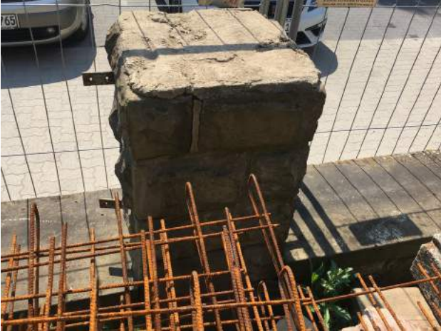
F 1: Fehlende und verlorene Mauerwerkskrone
