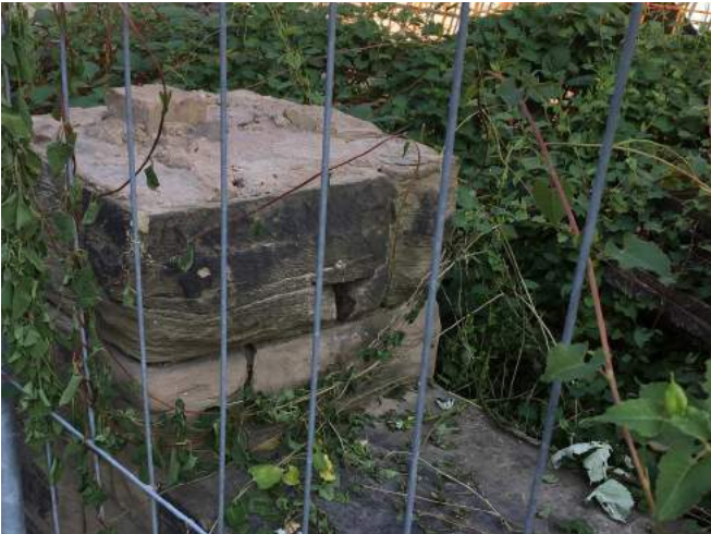
E 3: SP 4 fehlende Zaunverankerung unten rechts
