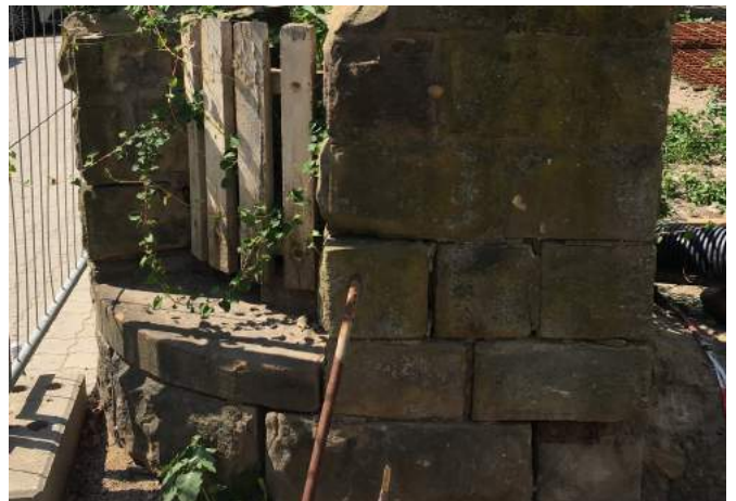
L 7: Untere geschweifte Mauerkrone durch Setzung des Torpfosten Ost gelockert
