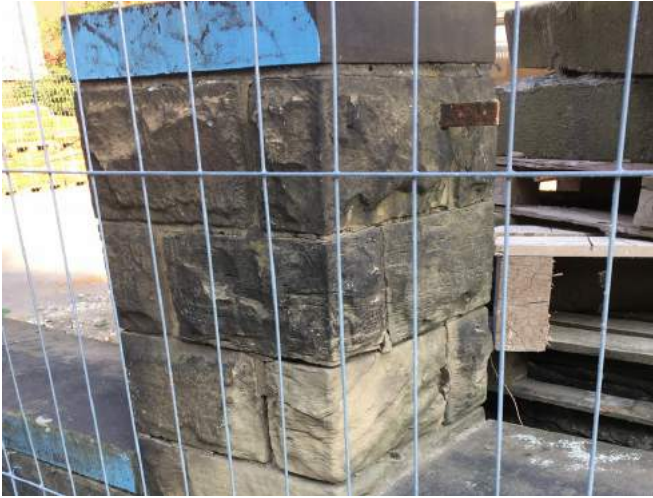
E 1: Sandsteinpfosten 1 (SP1)- Fehlende Zaunverankerung unten rechts
