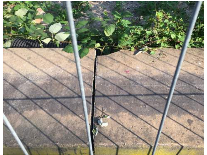
f 7: Grössere abgebrochene Ecke an der Rückseite der mittleren Mauerkrone zwischen SP 6 und dem linken Pfosten des östl Mauerwerksende
