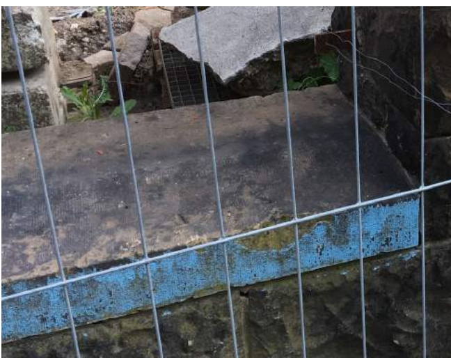
f 1: Grösserer Ausbruch an der Oberkante der rechten Abdeckung zwischen SP 2 und SP 3 sowie
