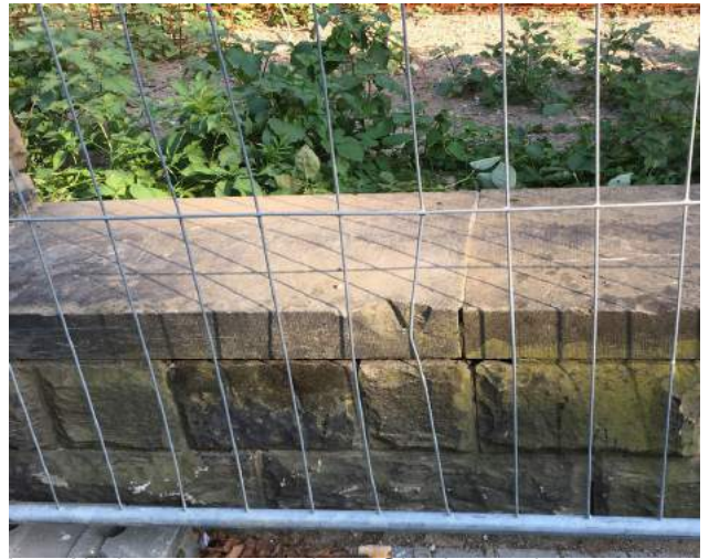
f 4: Abplatzung an vorderer Oberkante der linken Mauerkrone zwischen SP 5 und SP 6
