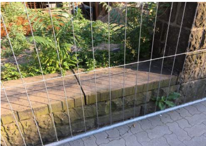
L 6: Rechte Mauerkrone zwischen SP 6 und TP Ost Stoßfuge offen und leicht angehoben
