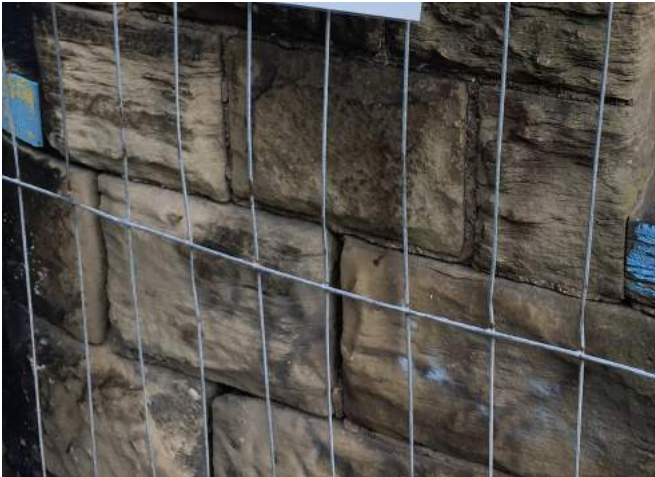
V 1: Abgewitterte Bereiche durch entfestigte Oberfläche aufgrund Krustenbildung im Übergang zum Torpfosten (TPWest)
