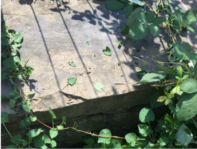
f 6: Abplatzungen an der hinteren Oberkante der mittleren Abdeckplatte zwischen SP 3 und SP 4
