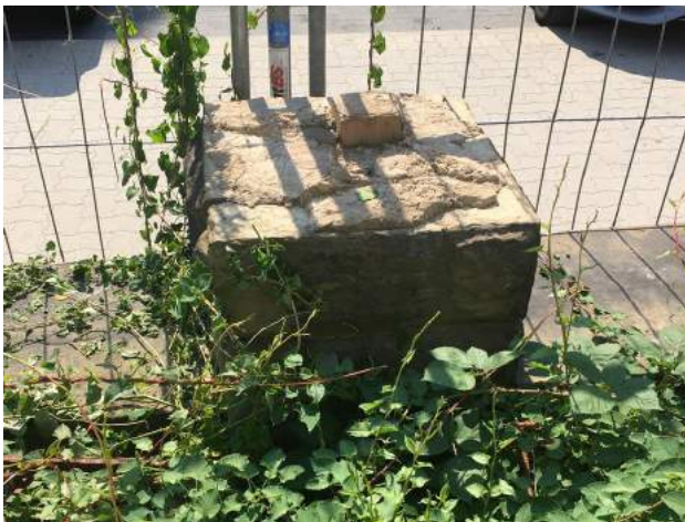
F 3: Zwei fehlende Mauerwerksschichten und fehlende Mauerwerkskrone
