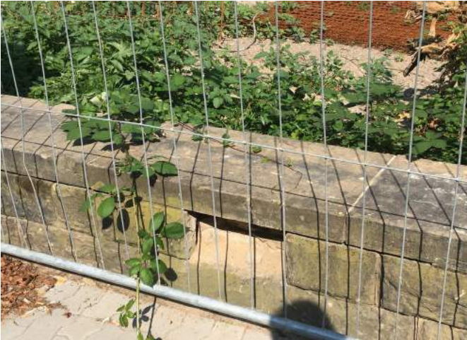
F 7: Fehlender Sandsteinquader in der oberen Mauerwerksschicht zwischen SP 5 und SP 6
