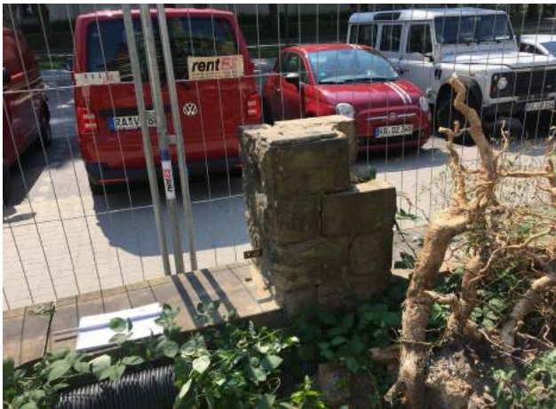
F 5: Fehlende Mauerwerkskrone an Pfosten SP6 und
