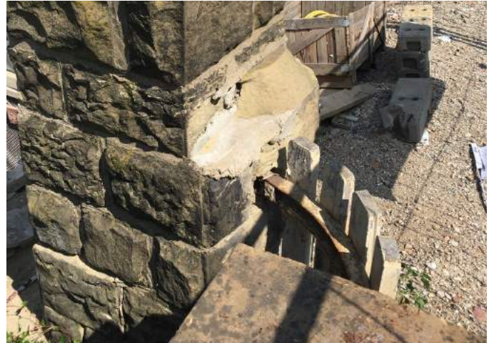
F 6: Abgerissene und fehlende geschweifte Abdeckplatte am Torpfosten d. östl. Mauerwerksende
