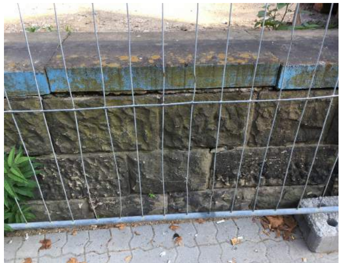
L 2: Nach innen verschobene mittlere Mauerkrone ohne Untergrundhaftung zwischen TP West und SP 1.
