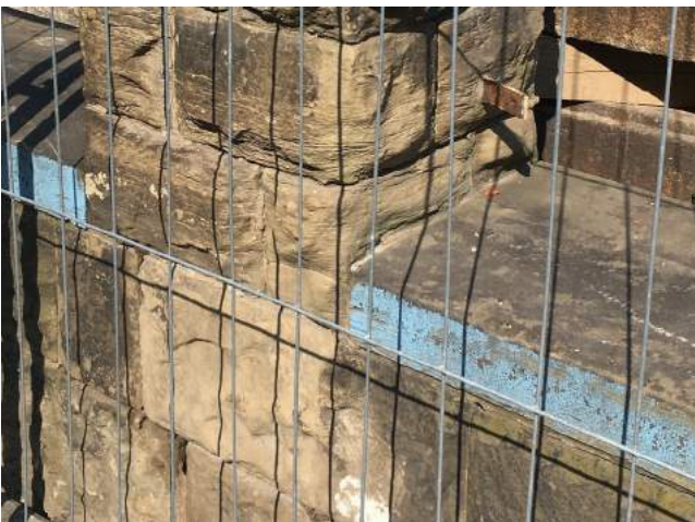
V 3: Schalenbildung am Eckbereich des Pfosten (SP2) sowie entfestigte Oberfläche am Mauerstein unterhalb des Pfostenansatzes.
