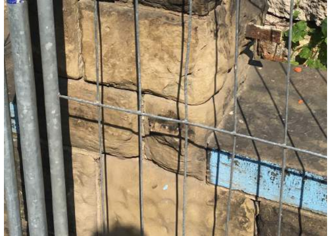
V 4: Schalenbildung am Eckbereich des Pfosten SP3 und entfestigte Oberfläche (Absandung) am Mauerstein unterhalb des Pfostenansatzes.
