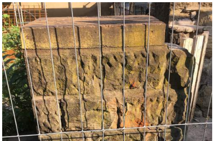
G 8: Betroffen ist auch die Stirnseite der Abdeckung des östlichen Abschlußpfostens
