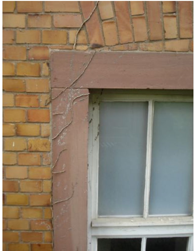
1.5.2 linkes Fenstergewände EG - Efeureste eingetrocknet
