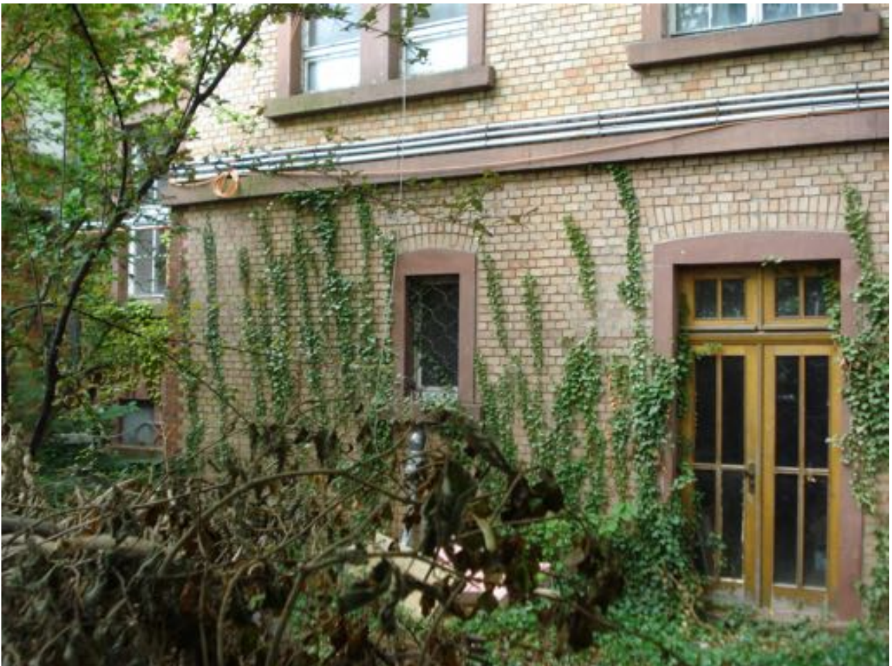
Starker Efeubewuchs entlang des gesamten Sockelgeschosses (KG) des rechten Flügels
