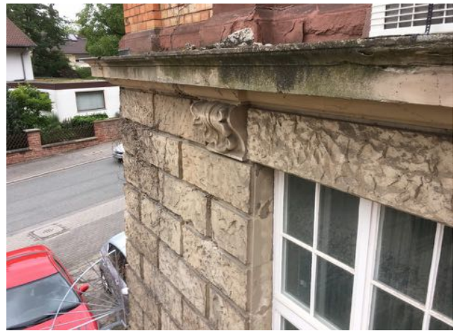
3.2.12 Gurtgesims Sockelgeschoß – Schalenbildung und Verkrustungen entlang der Hohlkehle
