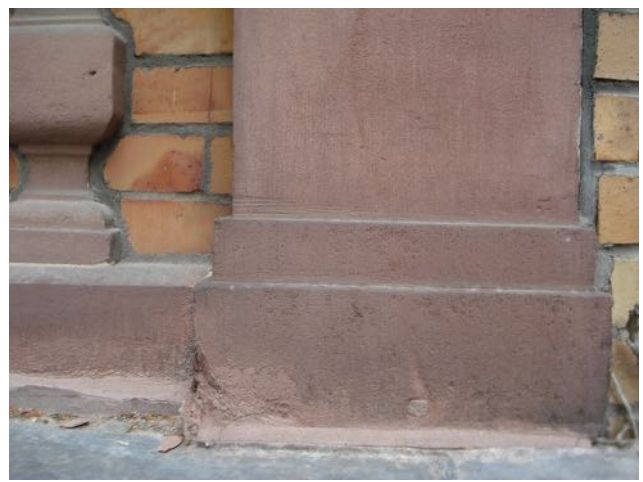
1.2.6 Ballustradensockel 1.OG rechts Fehlstelle durch Abschuppung im Übergang absandend
