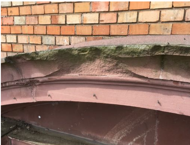
2.3.11 Fehlstelle am Segmentgiebel (s.o.) - möglicherweise durch mechanische Einwirkung
