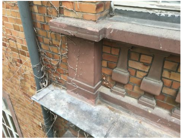
1.2.4 Ballustradenabdeckung 1.OG Mitte links Schalenbildung an der Oberfläche
