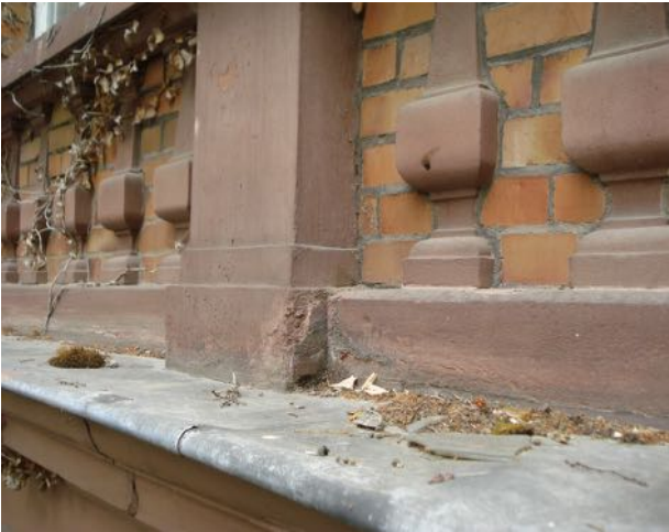
1.2.3 Ballustradensockel 1.OG Fassadenmitte - Schuppenbildung mit Absandung
