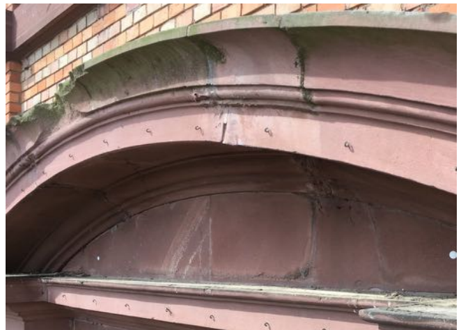
2.3.11 2.OG Fehlstelle am Segmentgiebel mit leichtem biogenem Befall sowie Metallhaken ohne Funktion
