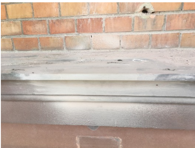
Fenstersturz 2.OG rechts
