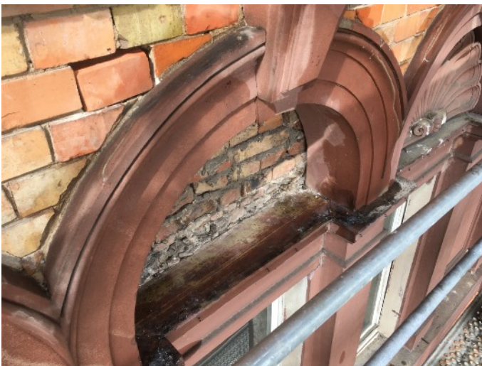
Fehlstelle an der Nord-Ost-Fassade
