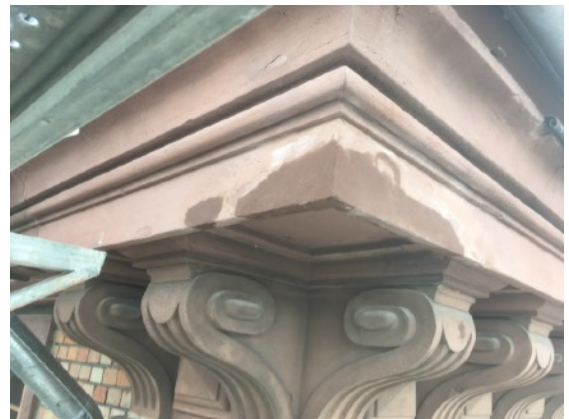
Ergänzte Ecke des Traufgesimses (SO/SW)
