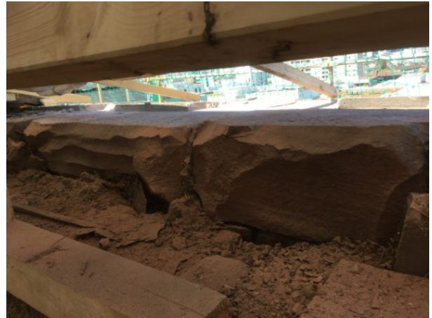
Bruchraue Rückseite der Gesimse
