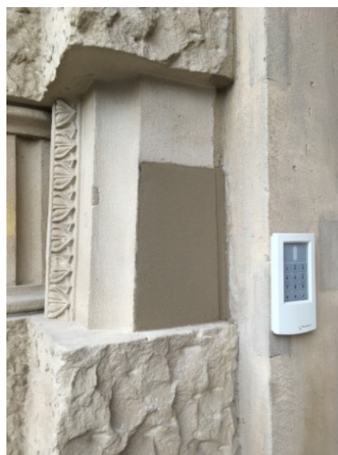
Reprofilierte Antragungen an Postament und Innenleibung des Haupteingangs der Nordost-Fassade
