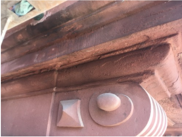
Auflager der Balkonkonsole 2.OG NO
