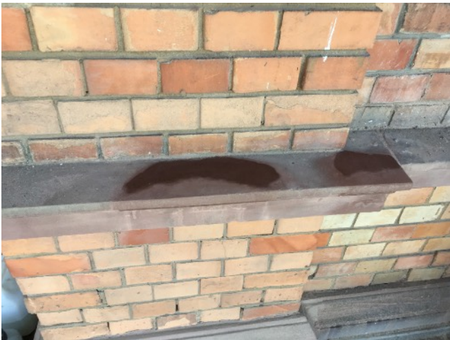
am Gurtgesims des 1.OG der NO-Fassade linke Gebäudehälfte aufgrund von Schalenbildung
